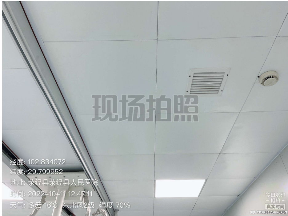
图 3-11 介入导管室通排风设施
