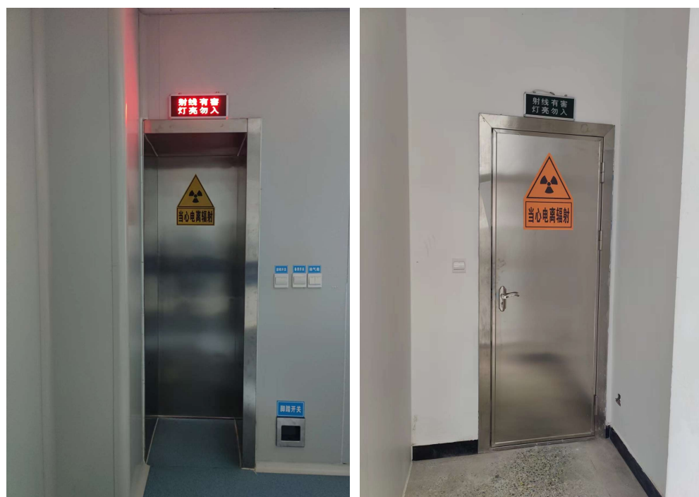
图 3-4 本项目防护门当心电离辐射警示标志及工作状态指示灯
