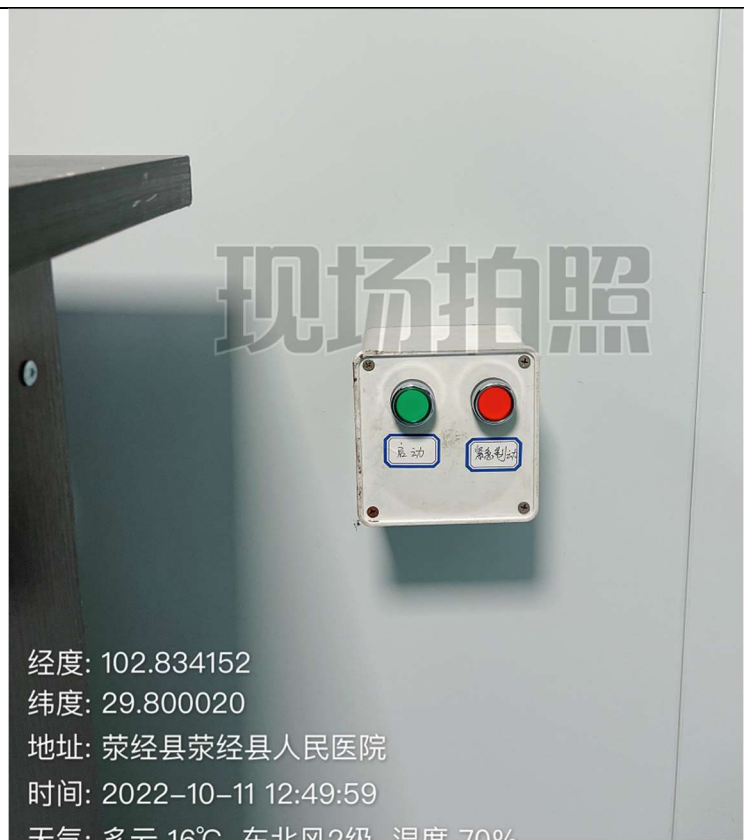
图 3-7 本项目控制室操作台旁急停按钮
